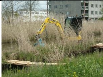
23/04, Tanthofkade, Delft, Freek Boon Broedseizoen of niet....?
