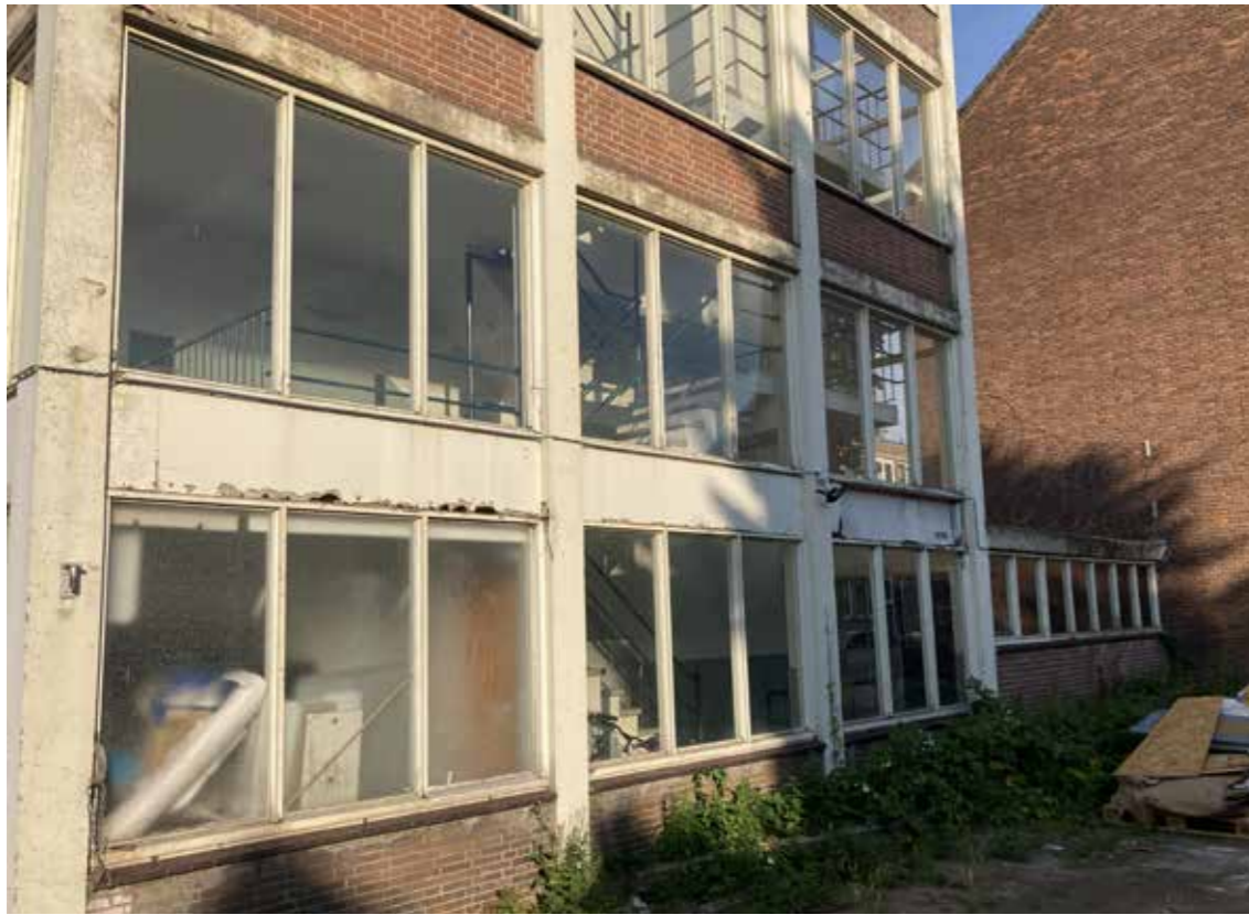
↑ Met de aanpak 'Grip op vastgoed' worden problemen zoals o.a. uitbuiting, brandgevaar, illegale bewoning, achterstallig onderhoud, aangepakt.
